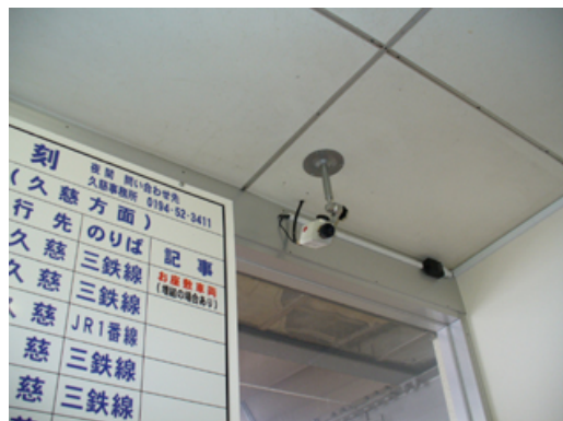
・防犯カメラ設置状況
