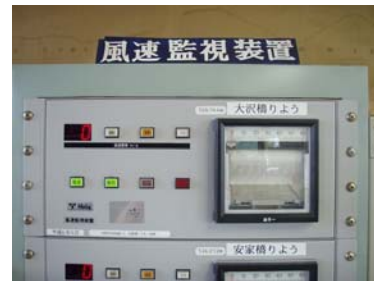
風速監視装置
