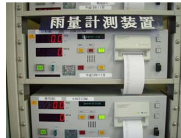
雨量監視装置
