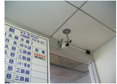
防犯カメラ設置状況
