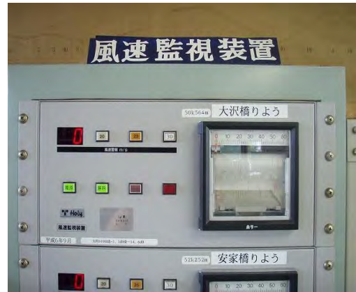
風速監視装置
