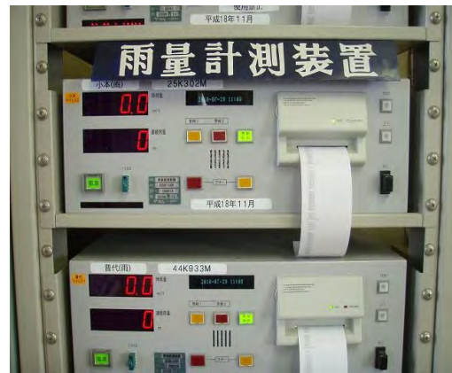
雨量監視装置
