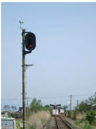
新たに設置した風速計（陸中野田駅）
