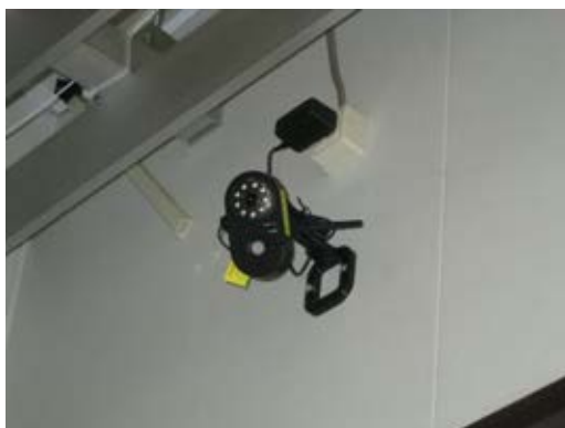
防犯カメラ設置状況
