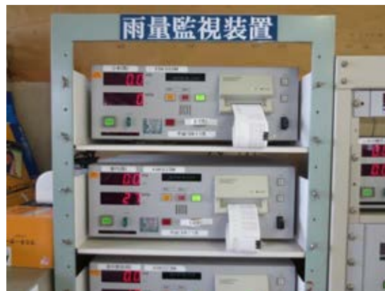
雨量監視装置
