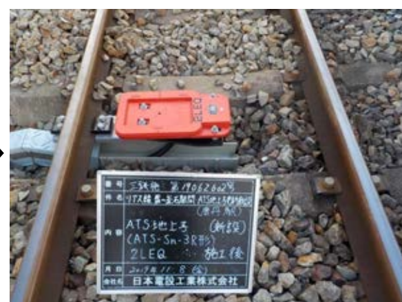
A T S更新・新設（後）
