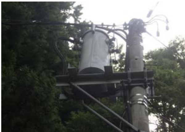
無線電源用変圧器更新（前）
