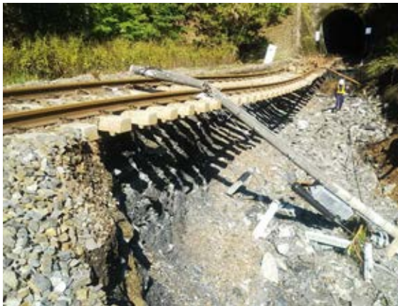
釜石～両石間の土砂流出
