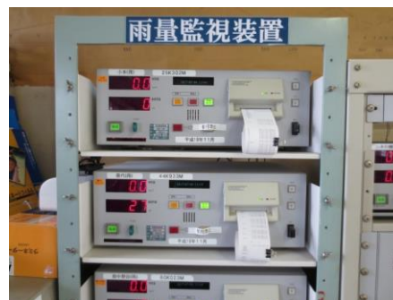
雨量監視装置
