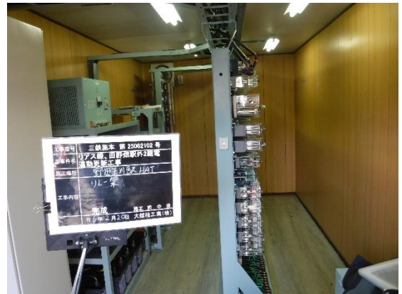
継電連動装置更新（後）
