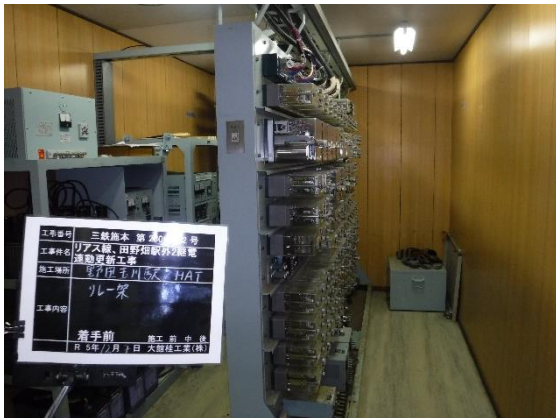
継電連動装置更新（前）
